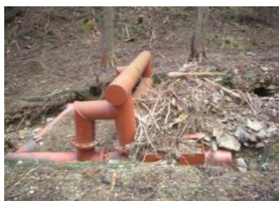
簡易流木止め施設が流木を捕捉
