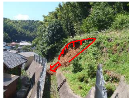
待ち受け擁壁が崩壊土砂を捕捉（丹波市）
