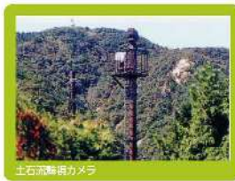
土石流監視カメラ
