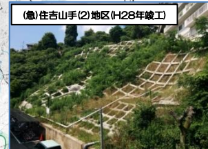
(急)住吉山手(2)地区(H28年竣工)
