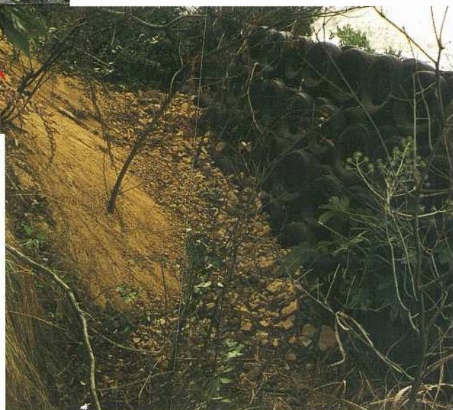
落石を未然に防止した既設落下防止柵
