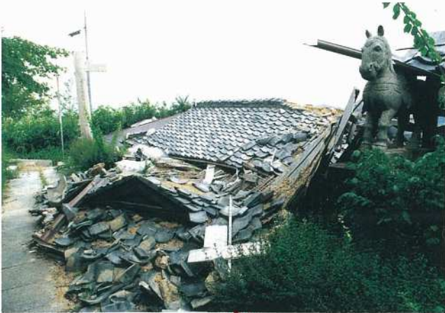
崩壊地上部住宅
