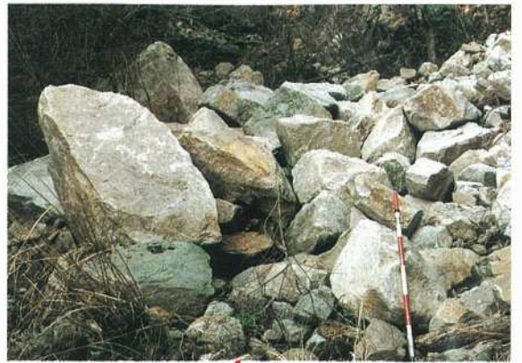
施行地上部の崩壊石礫の状況
