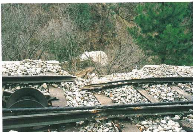
落下した転石で切断された軌道
