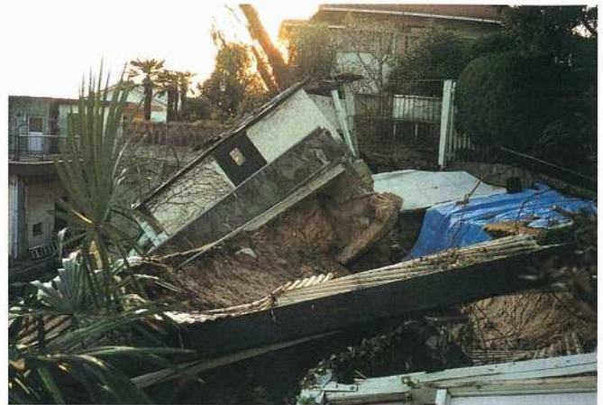
上部住宅地のクラック
