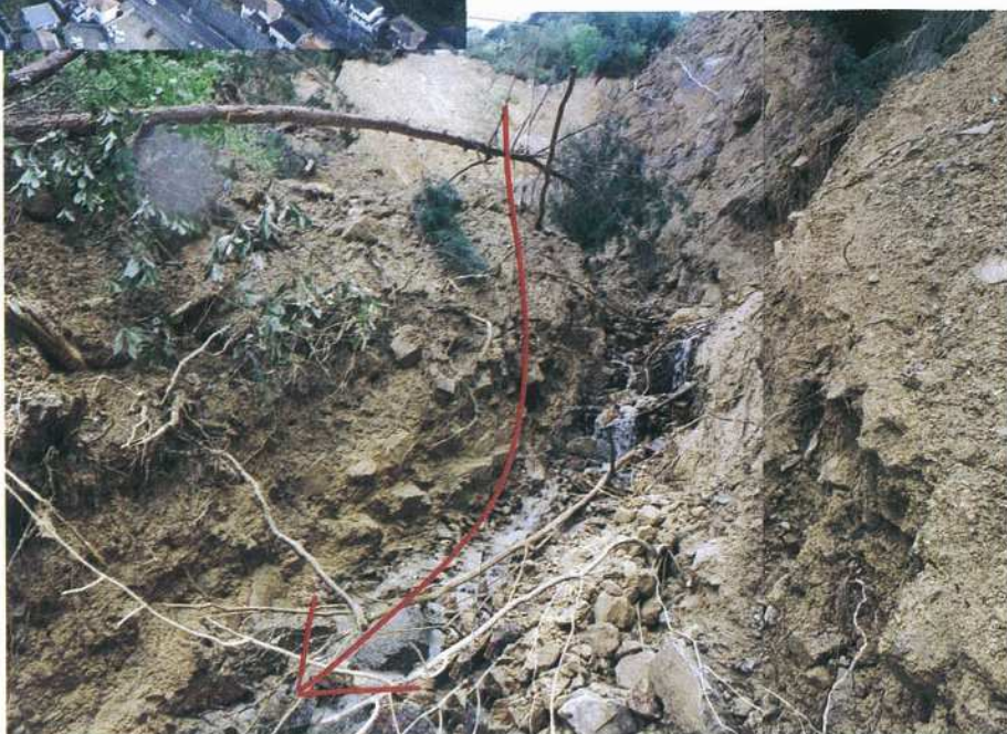
山腹上部崩壊
