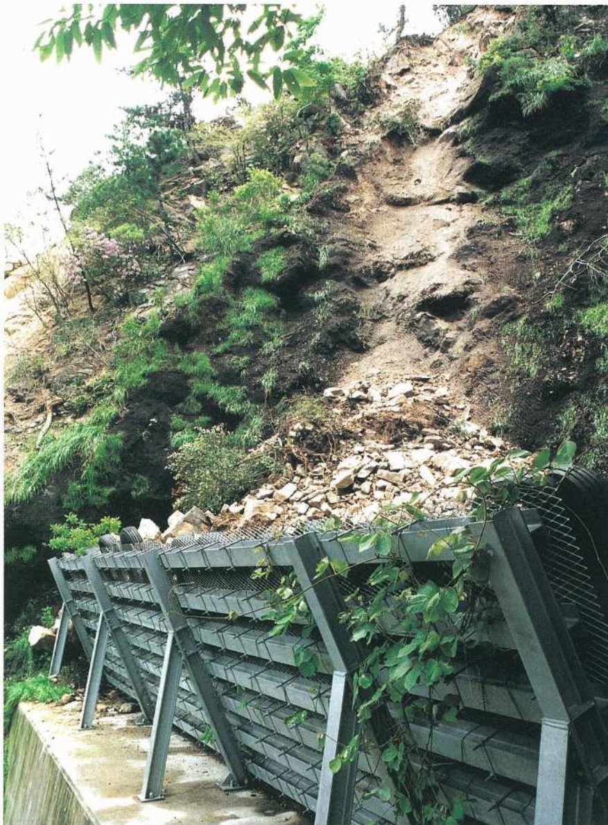
芦屋市奥山 落石防止柵が山腹から崩落した石礫をくいとめた。
