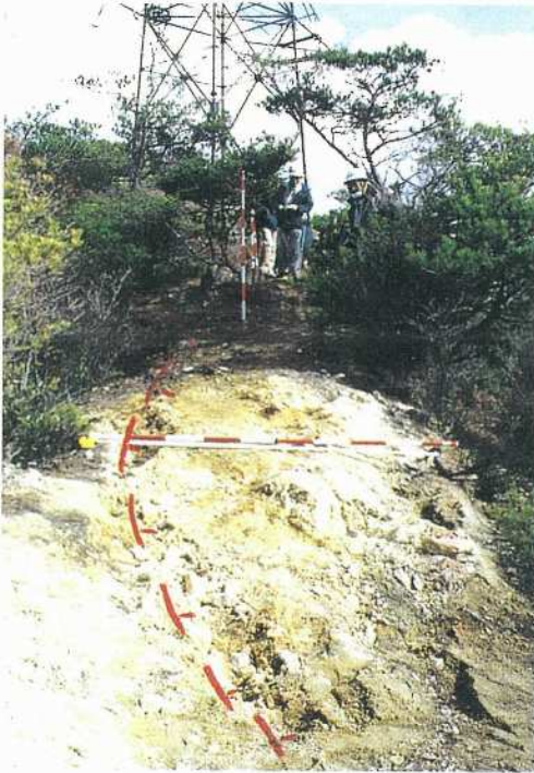
尾根付近クラック発生状況
