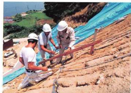
施工中に発生したクラックの緊急調査の状況 (平成7年7月撮影)
