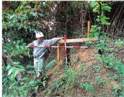
冠頭部クラックの状況
