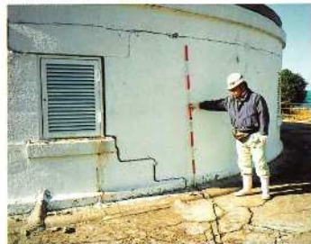
灯台のクラックの状況
