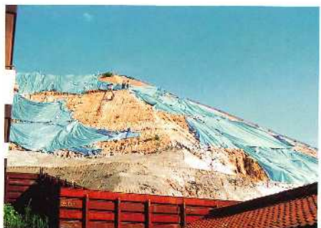
クラックに対する応急押え盛土及び仮設防護柵 (平成7年7月撮影)
