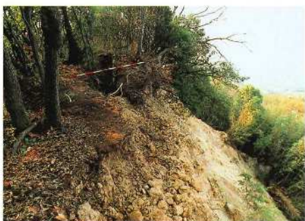
冠頭部のクラックの状況（平成7年4月撮影）
