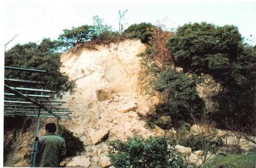
山腹崩壊の状況
