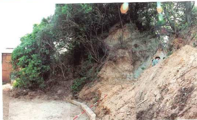
山腹崩壊状況
