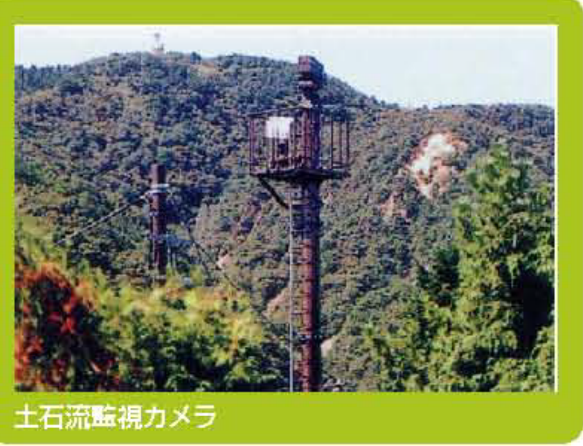
土石流監視カメラ
