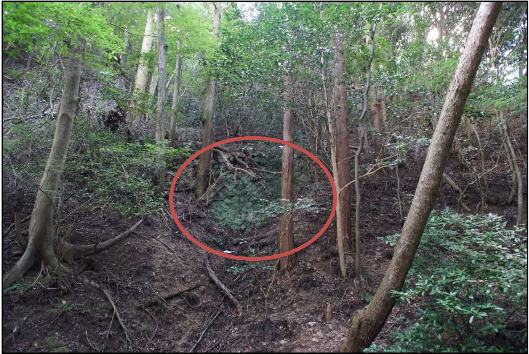
③ 石積土留工（イシズミドメコウ） 下流の状況 樹木の成長による影響を受けている
